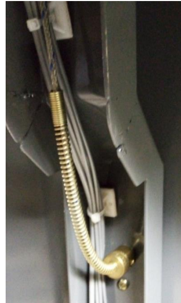
Figura 5 – Localização do termopar na canaleta lateral
