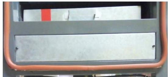
Figura 6 – Localização das resistências na parte inferior da estufa.
